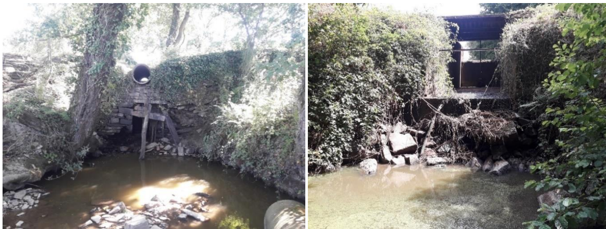
Figure 99 : Situations dégradées – Source : HARDY ENVIRONNEMENT
