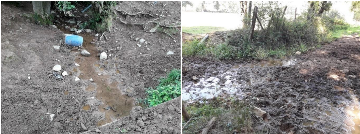
Figure 92 : Situations dégradées - Source : HARDY ENVIRONNEMENT
