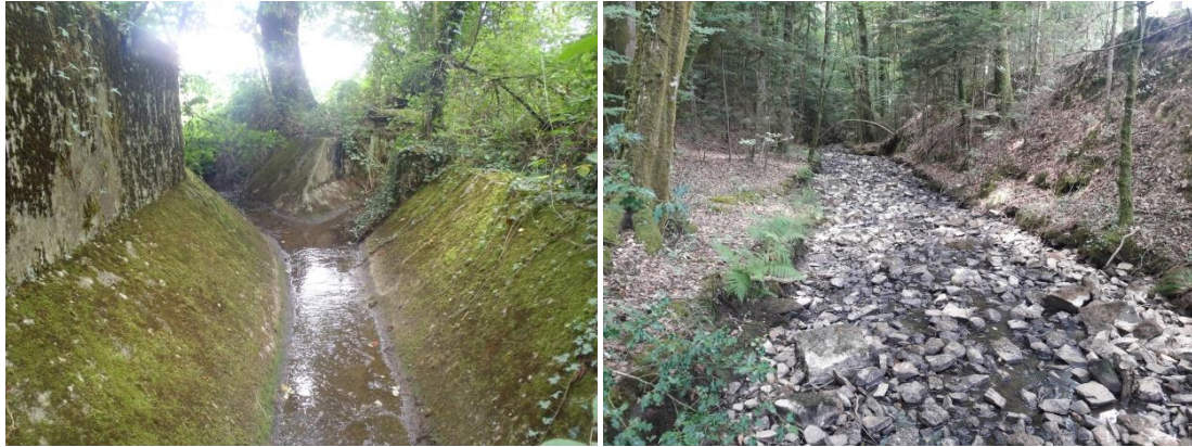
Figure 84 : Situations dégradées – Source : HARDY ENVIRONNEMENT
