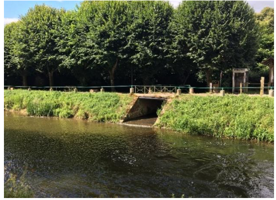
Ouvrage à l'exutoire de la Chatouillette à Malestroit
