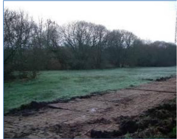
Exemple d'un cheminement provisoire en bois qui protège le sol de la parcelle (bassin du Rion, chantier ERDF)
