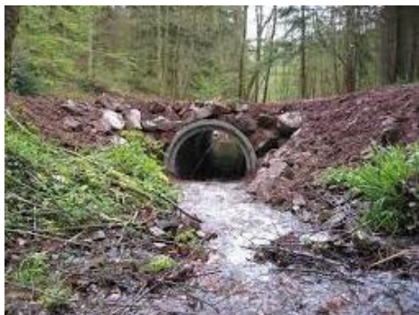
Passage busé béton
