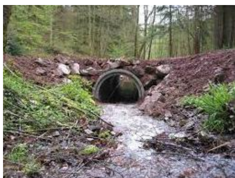
Passage busé béton
